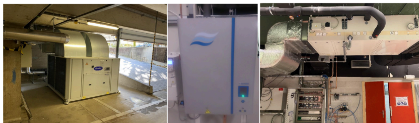
Van links naar rechts: nieuwe koelinstallatie, betere regeling voor vochtigheid en het systeem voor droge perslucht
