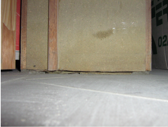
Foto van de onderkant van de chambranten aan de dubbele deur, duidelijk te kort.
