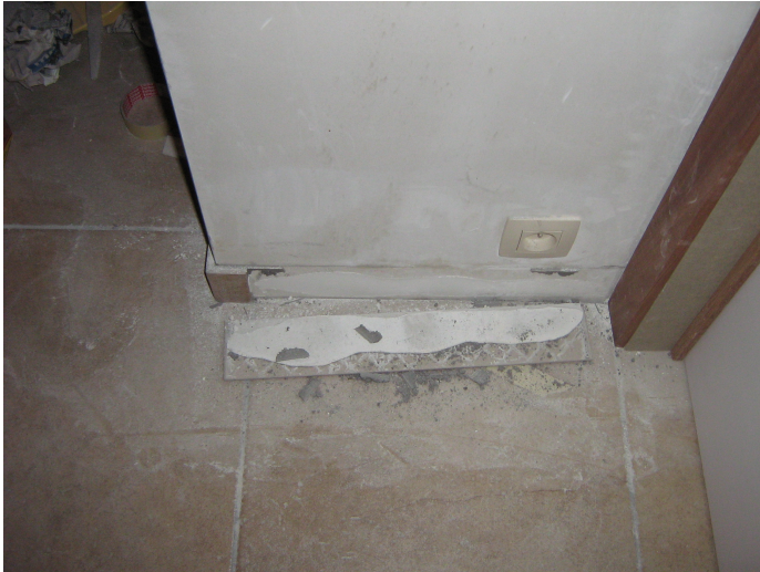
Foto van een van de plinten die los gekomen is.
