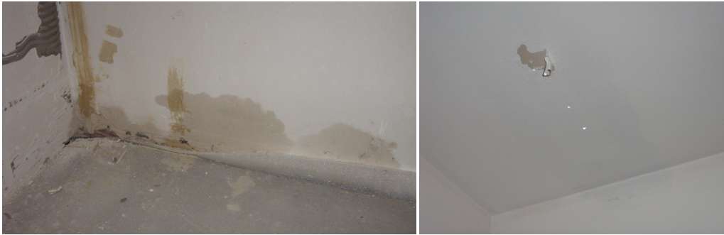
Foto's: vochtplekken in badkamer 1 (links) en water uit het plafond in wasruimte (rechts).
