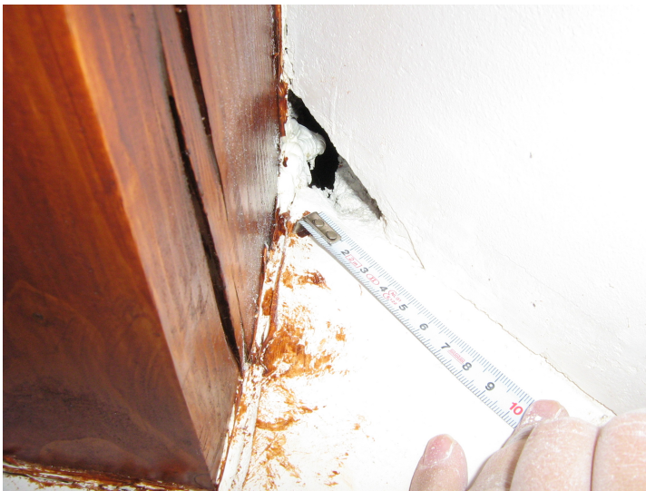
Foto van het gat na het afbrokkelen van het pleisterwerk.
